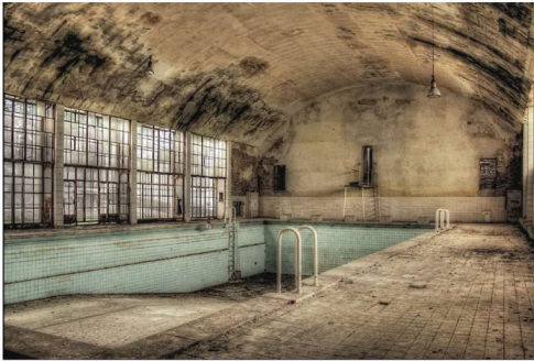
Derzeit baupolizeilich gesperrter Innenraum der Schwimmhalle, 2009
